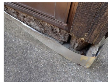
木造住宅土台部の腐朽
