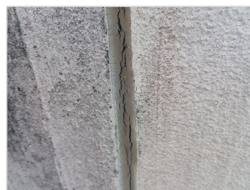
シーリングの劣化
